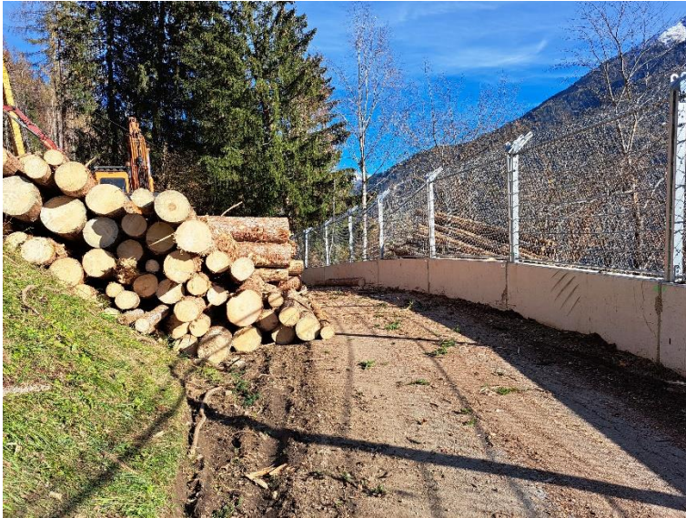
Steinschlagschutznetz auf Jersey Wand (Foto WLW)
