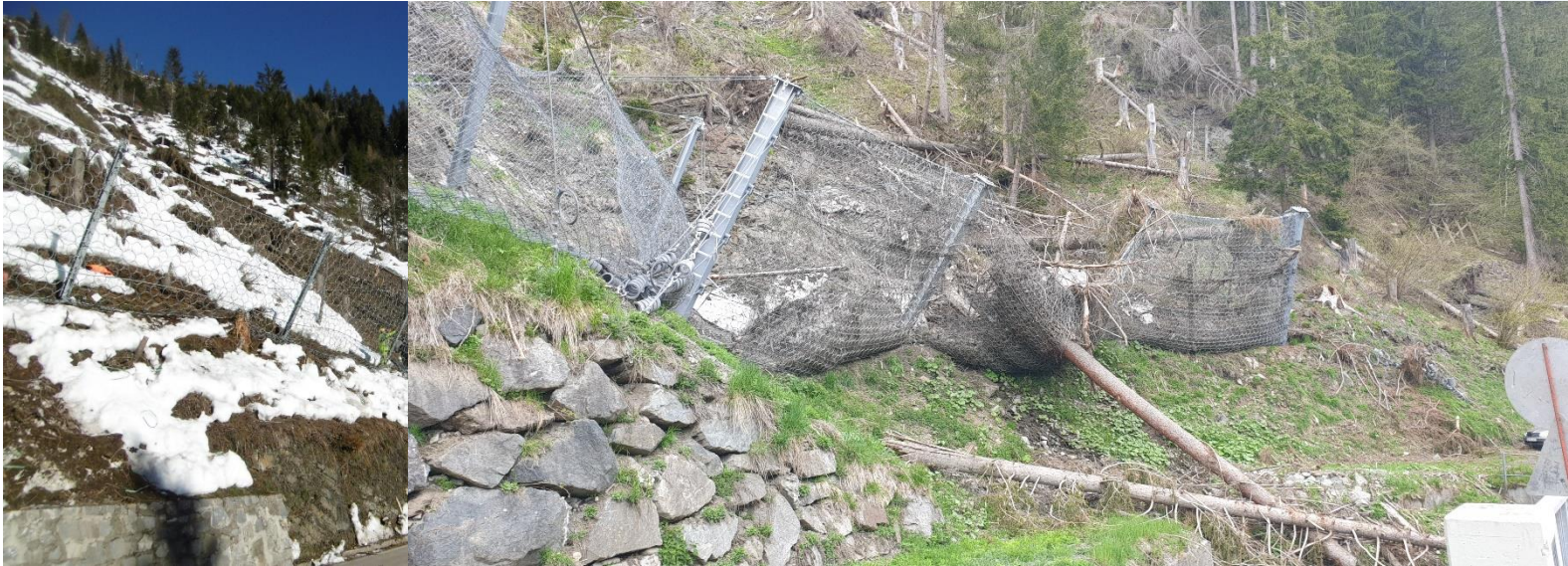
Steinschlag-/Lawinenschutz B111 - Promeggen (Fotos WLW)
