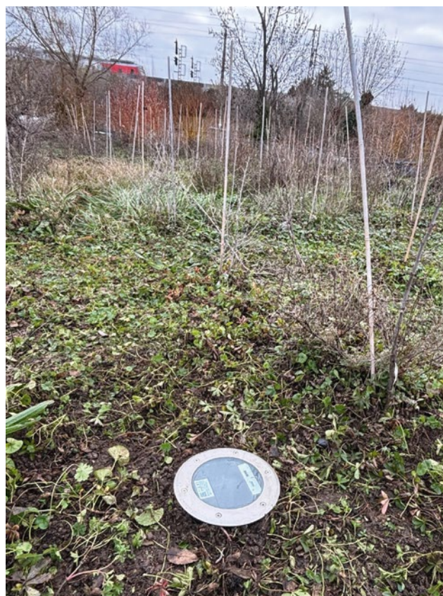
Bodensensoren mit Photovoltaik-Versorgung
